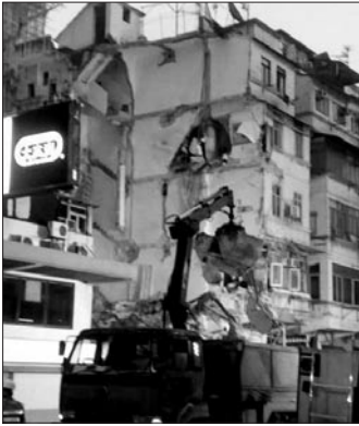
馬頭圍道舊樓倒塌現場情況
